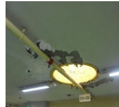
劣化した三軒屋自転車 駐車場の天井
